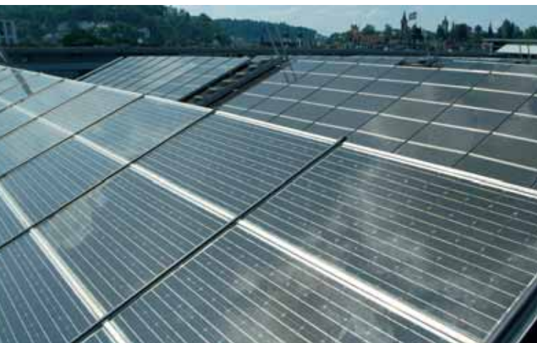
Fotovoltaikanlage auf dem Bahnhof Luzern
